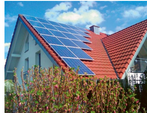
Mit Photovoltaik sauberen Strom aus Sonnenschein gewinnen
